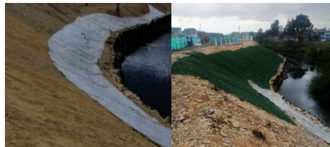
Foto 3. Colocación de los módulos de Colchacreto Articulado e Instalación de los módulos de Geocelda para posterior llenado con material fértil
