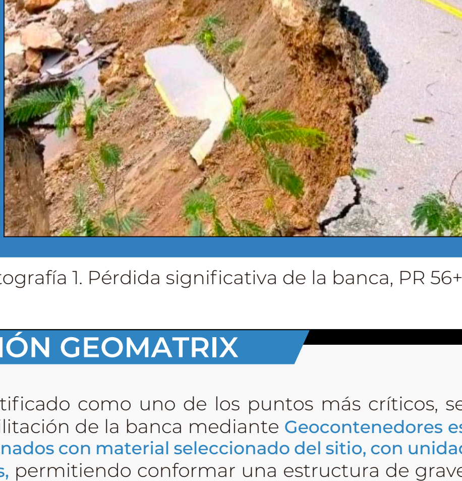
Fotografía 1. Pérdida significativa de la banca, PR 56+300
