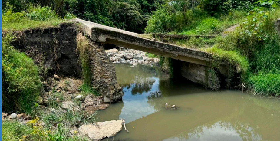
Fotografía 1. Vista frontal de puente fallado.
